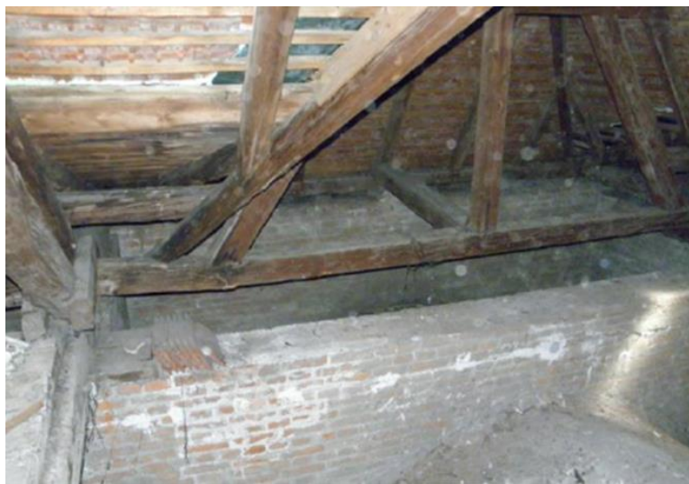
Slika 27. Oštećenje greda drvenog krovništva (Foretić i Trogrlić, 2021)
