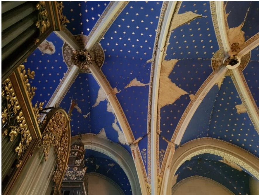
Slika 22. Oštećeni svod iznad pjevališta (Foretić, 2021)
