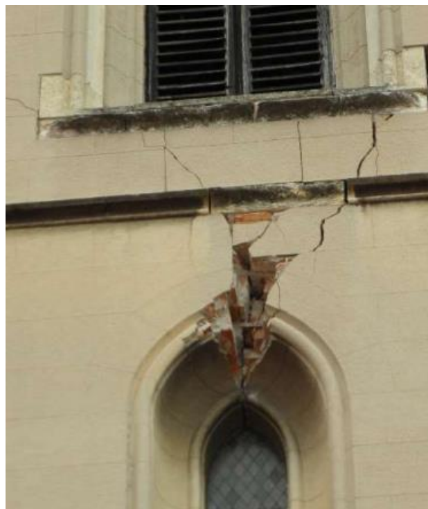
Slika 29. Detalj pukotine i oštećenja nadvoja na zapadnom zidu zvonika (Foretić, 2021)
