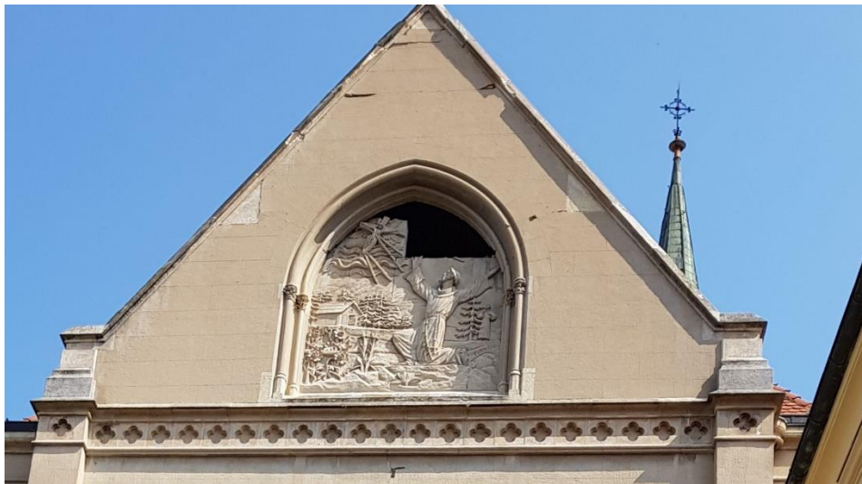
Slika 25. Oštećenja na zabatnom zidu i reljefu (Foretić, 2021)
