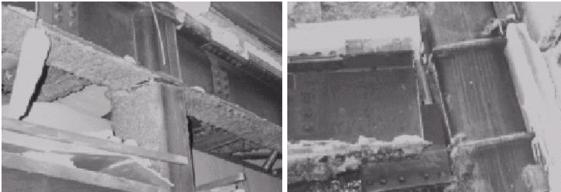
Slika 5 Oštećenje na zavarenim spojevima grede i stupa: lom na vrhu stupa (lijevo) i kraju grede (desno) u potresu Kobe u Japanu [5]
