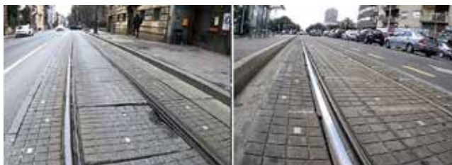
Slika 4. Oštećena armiranobetonska ploča na kolosijeku u sastavu cestovne prometnice (lijevo), propali neoprenski ulošci uz vrat tračnice i ispadanje elastomerne brtvene trake (desno) [6]
