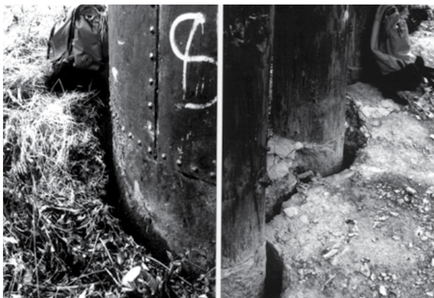
Slika 12. Pukotina uz vrh pilota kao posljedica cikličnog opterećenja pilota u glini, prema [56]
