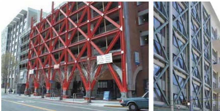
Slika 8. Zgrade ojačane vanjskim čeličnim vezovima
