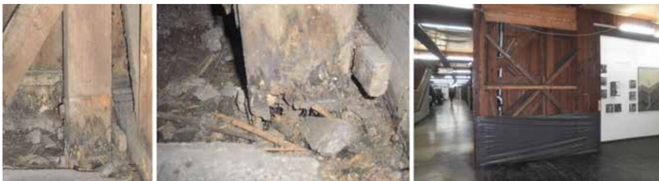
Slika 9. Ozbiljna oštećenja i gubitak nosivosti stupova
