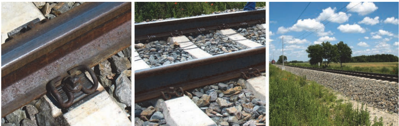
Slika 11. Jednokolosiječna elastična pritiskalica SKL-14 (lijevo), pragovi tipa HŽ - PB85-K (sredina) i zastorna prizma od drobljenca (desno)
