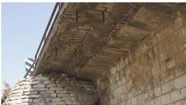
Slika 5. Loše stanje konzola mosta
