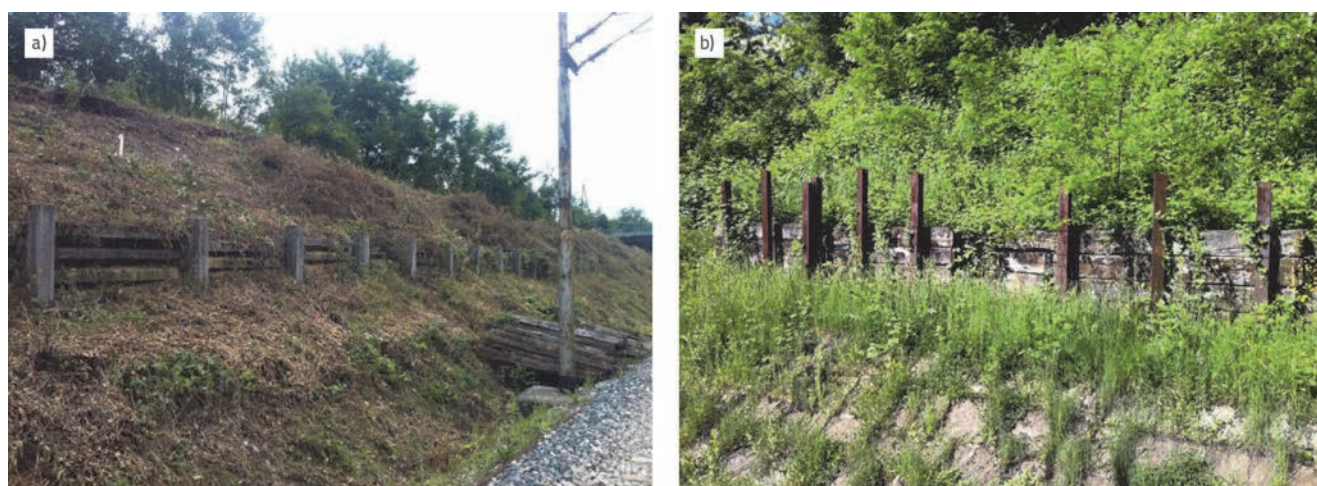
Slika 1. Sanacija klizanja tla: a) montažnim betonskim zidom; b) zidom od zabijenih tračnica i drvenih pragova
