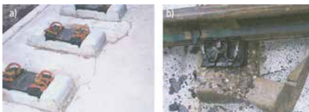
Slika 10. Degradacije na kolosijecima: a) Pukotine uslijed skupljanja betona, b) Oštećenja ležajnih mjesta tračnica, [42]
