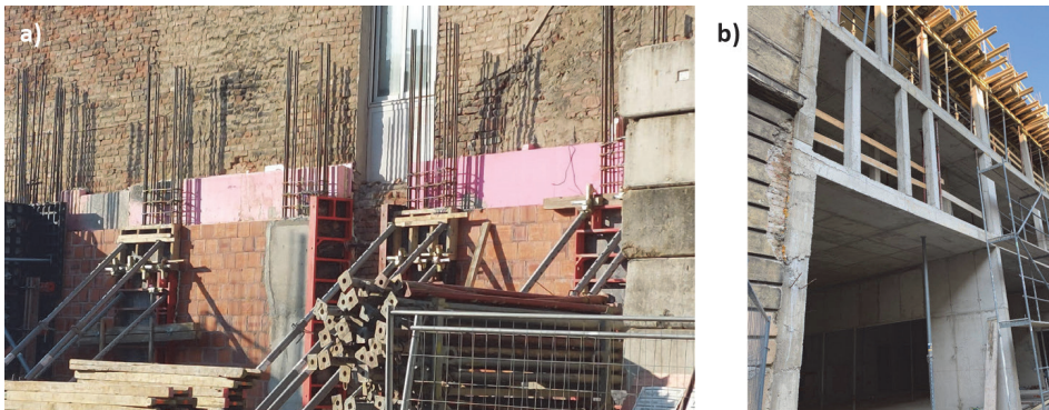
Slika 6. Primjer izgradnje moderne zidane i armiranobetonske zgrade unutar Zagrebačkog bloka (fotografirano 4. ožujka 2022.) – a) razdjelnica ispunjena toplinskom izolacijom; b) bez razdjelnice
