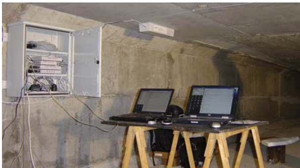
Slika 3. Monitoring centar (mjerna stanica)
