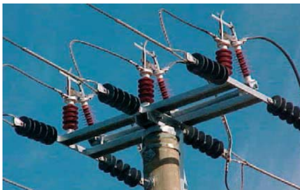
Slika 10. Kompozitni potporni izolatori ugrađeni na rastavljaču
