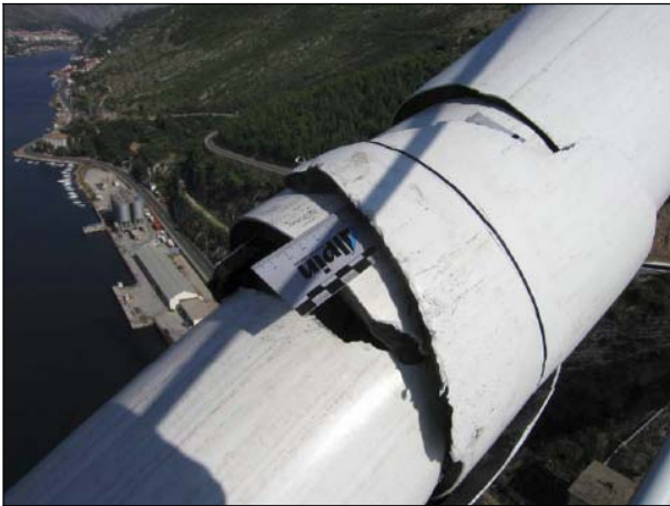
Slika 9. Oštećenje zaštitne cijevi
