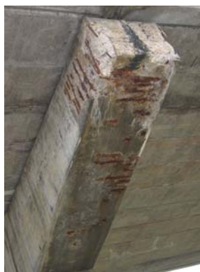
Slika 23. Ogoljena armatura na naglavnoj gredi stupa nadvožnjaka tipa SO
