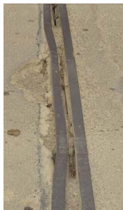
Slika 36. Primjer oštećenja prijelazne naprave
