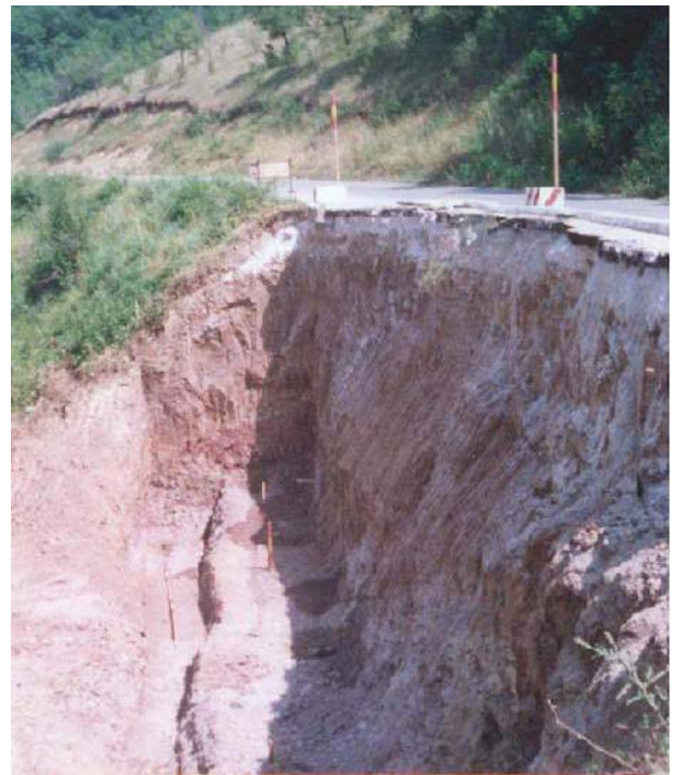
Slika 4. Karakterističan odron uz prometnicu u fazi sanacije
