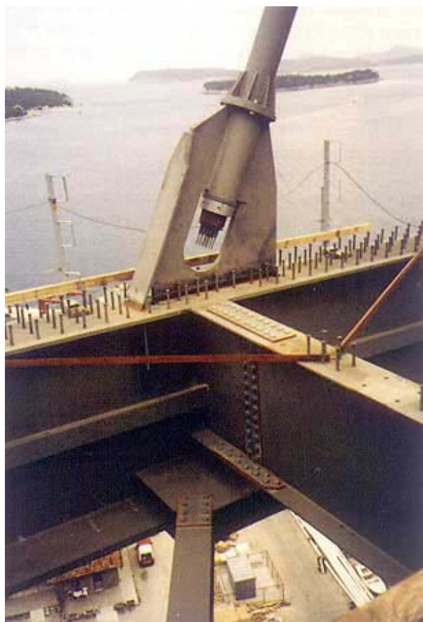
Slika 4. Detalj glavnog i poprečnog nosača uz pričvršćenje kose zatege, prije izvedbe ploče
