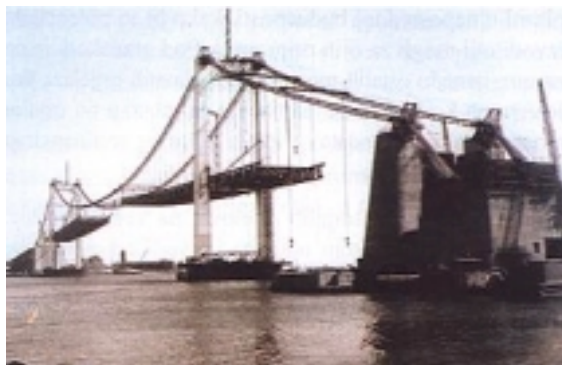
Slika 22. Montaža noseće grede mosta Throgs Neck, s masivnim sidrenim blokom u prvom planu
