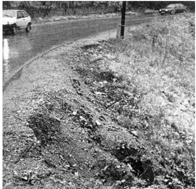
Slika 6. Pogled na privremeno saniranu cestu preko klizišta na kojoj su vidljive pojave erozije uslijed nekontroliranih zahvata voda s kolničke konstrukcije
