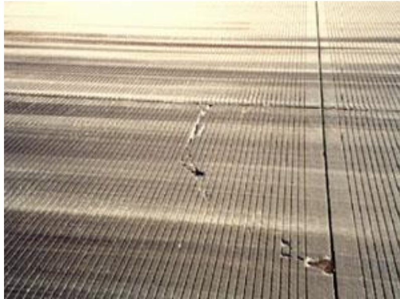
Slika 9. Kutna pukotina (srednje oštećenje) [15]
