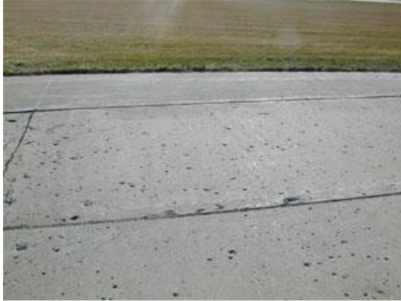
Slika 14. Odvajanje zrna agregata [15]
