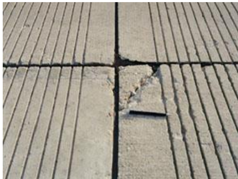
Slika 20. Lom u kutu (malo oštećenje) [15]
