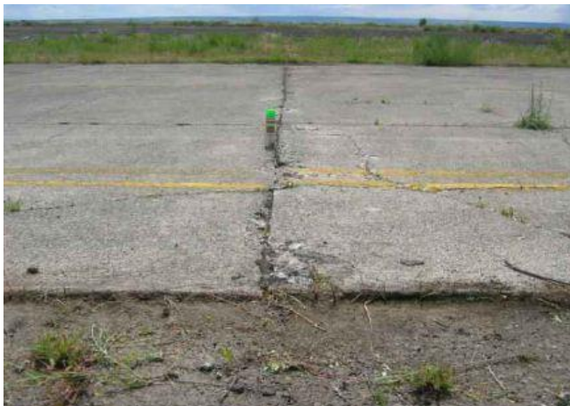
Slika 8. Denivelacija ploča (malo oštećenje) [15]
