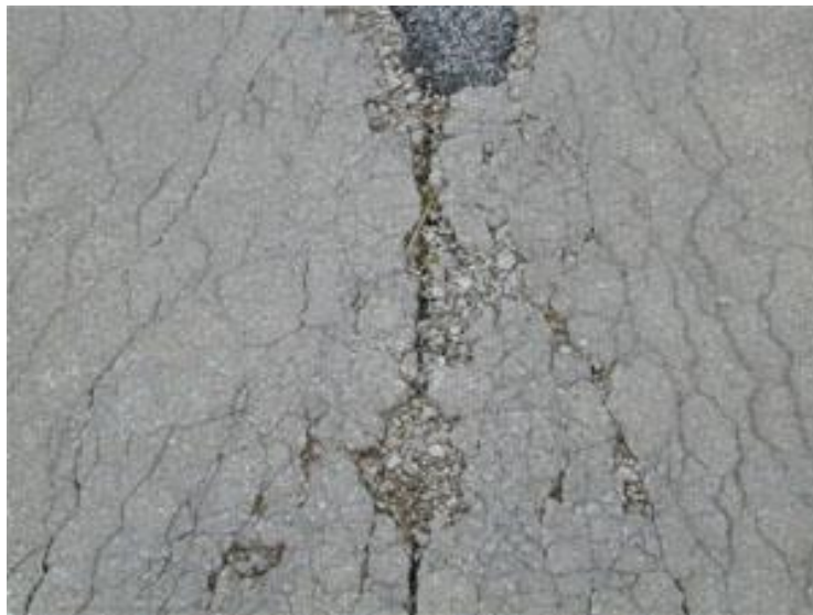
Slika 11. „D” pukotina (veliko oštećenje) [15]
