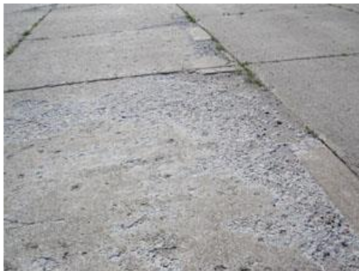
Slika 15. Ljuštenje (veliko oštećenje) [15]
