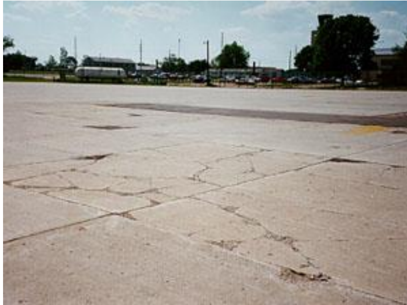
Slika 17. Pukotine koje se presijecaju (veliko oštećenje) [15]
