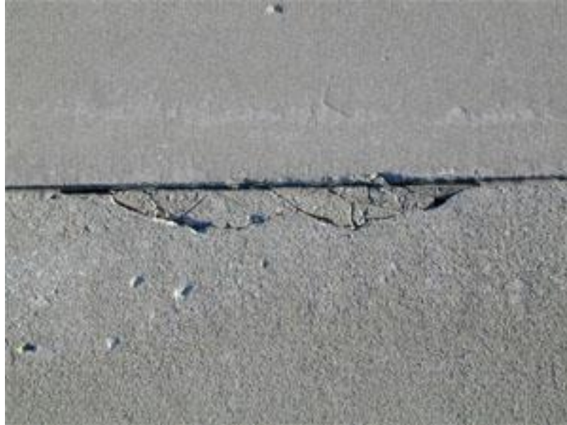
Slika 19. Pukotina uz razdjelnicu (srednje oštećenje) [15]
