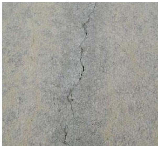
Slika 10. LTD pukotine (malo oštećenje) [15]
