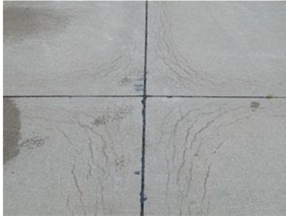
Slika 4. "D" pukotina srednjeg stupnja oštećenja [10]
