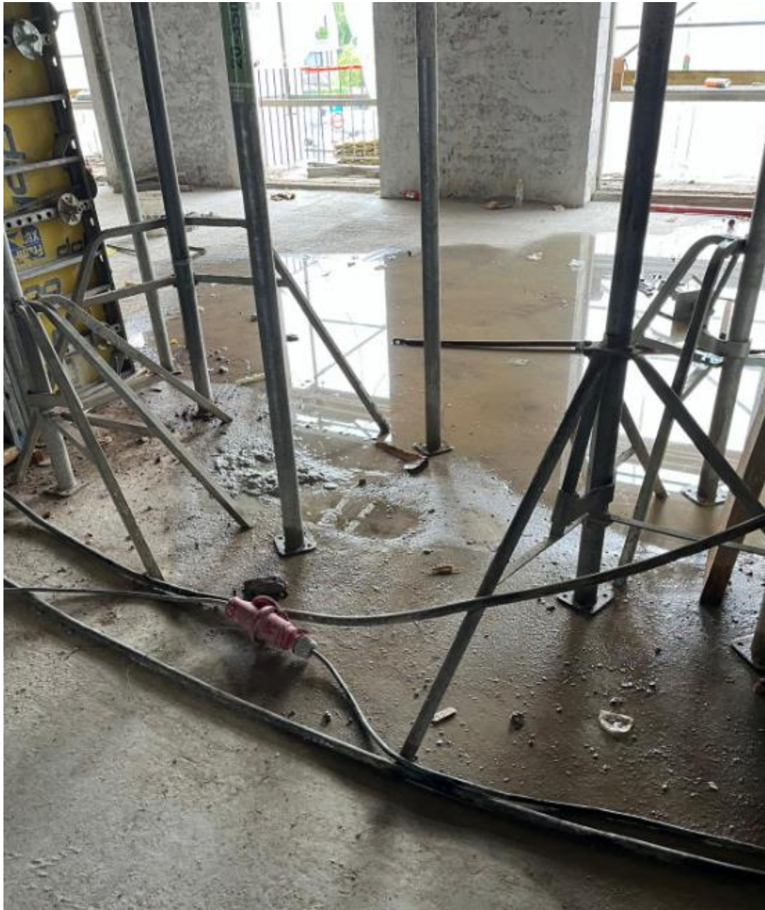
Slika 48.: Opasnost kontakta električnih instalacija i vode
