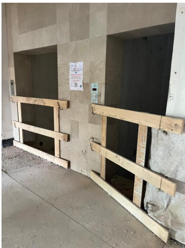
Slika 27.: Zaštita okna dizala
