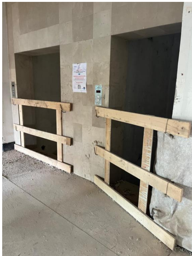
Slika 27.: Zaštita okna dizala
