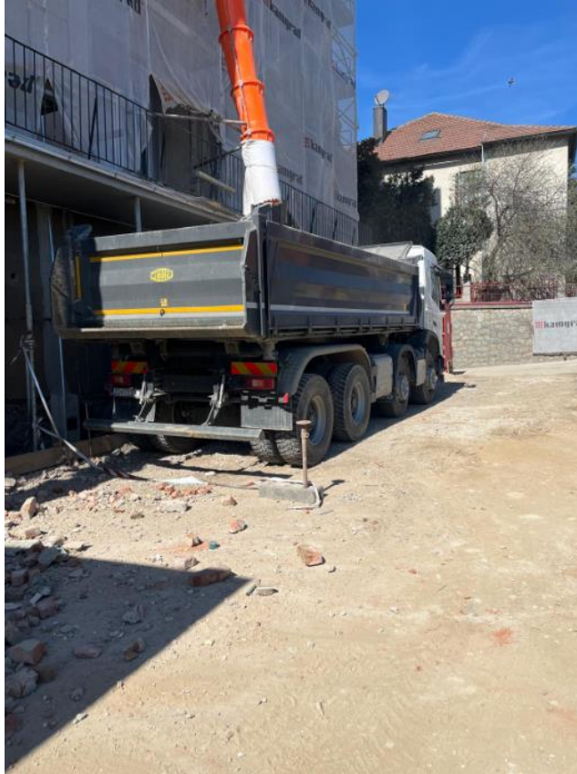
Slika 19.: Cijev za šutu i odvoz kamionom
