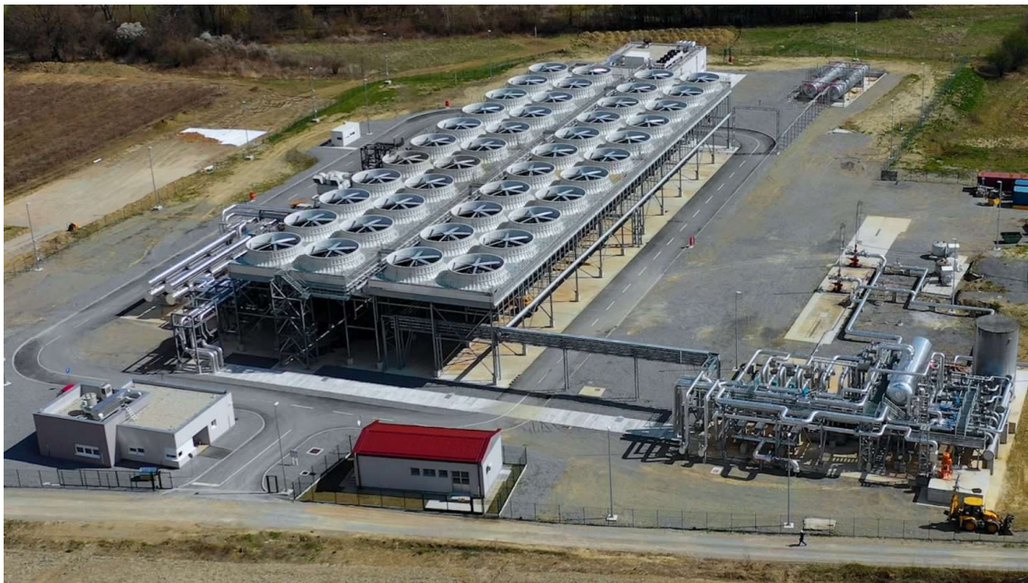
Slika 15.: Geotermalna elektrana „Velika 1“ (OIE Hrvatska, 2019)
