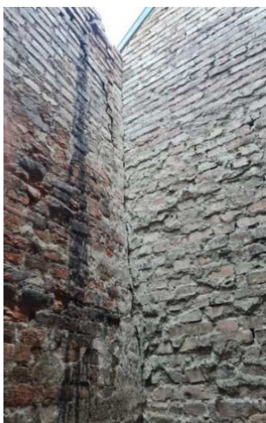
Slika 27: Sjeverni svjetlarnik sa vidjivim pukotinama nakon potresa 2020.
