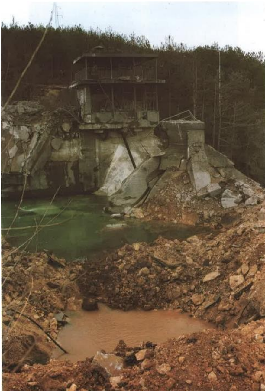
Slika 10: Oštećenje lijevog kraja brane (Izvor: [4])
