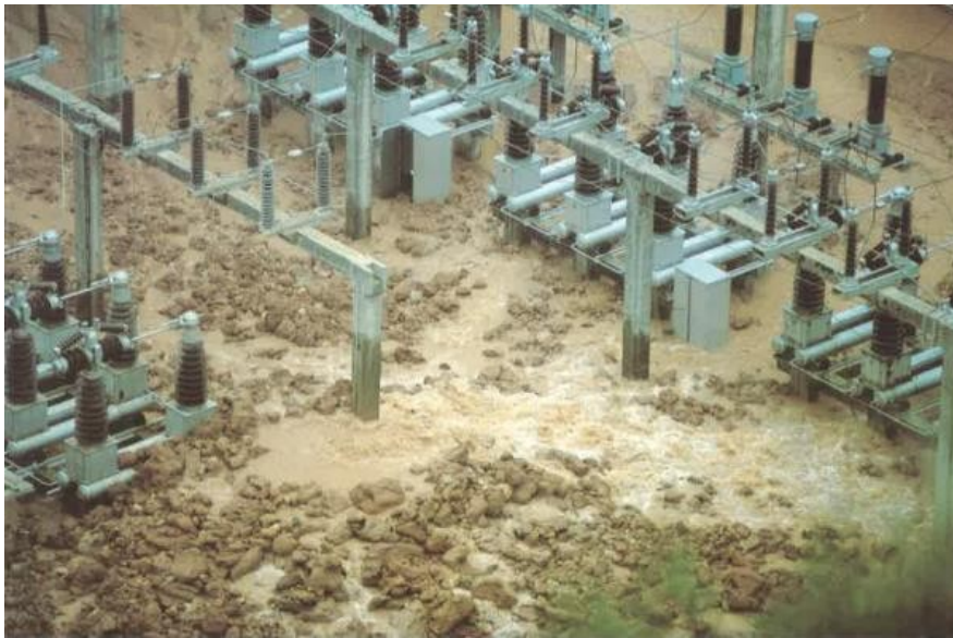
Slika 12: Rasklopno postrojenje HE Peruća (Izvor: [4])
