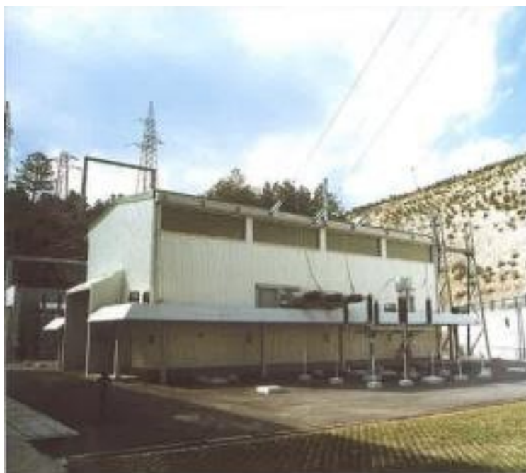
Slika 6: Rasklopno postrojenje HE Peruća (Izvor: [2])
