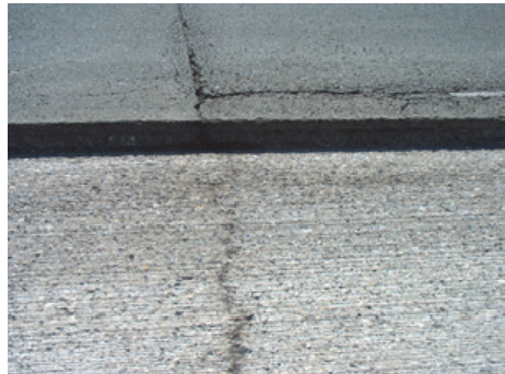
Slika 3. Poprečna i uzdužna pukotina [4]
