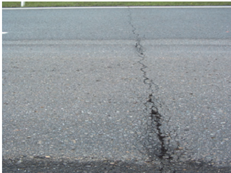
Slika 2. Izražajna strukturna pukotina [4]
