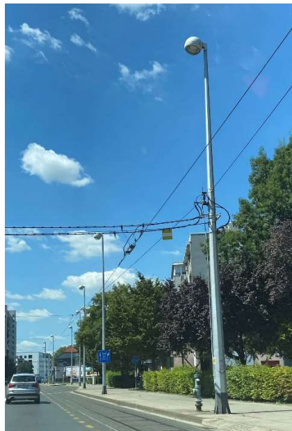
Slika 23.: Rasvjetni stup na koji je spojena tramvajska mreža u Dubravi (Izvor: autor)
