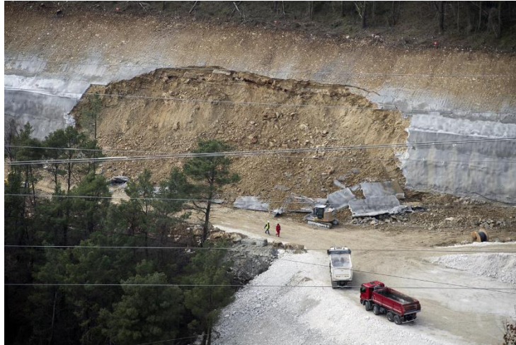
Slika 24.: Urušavanje dijela usjeka kod pristupnih cesta
