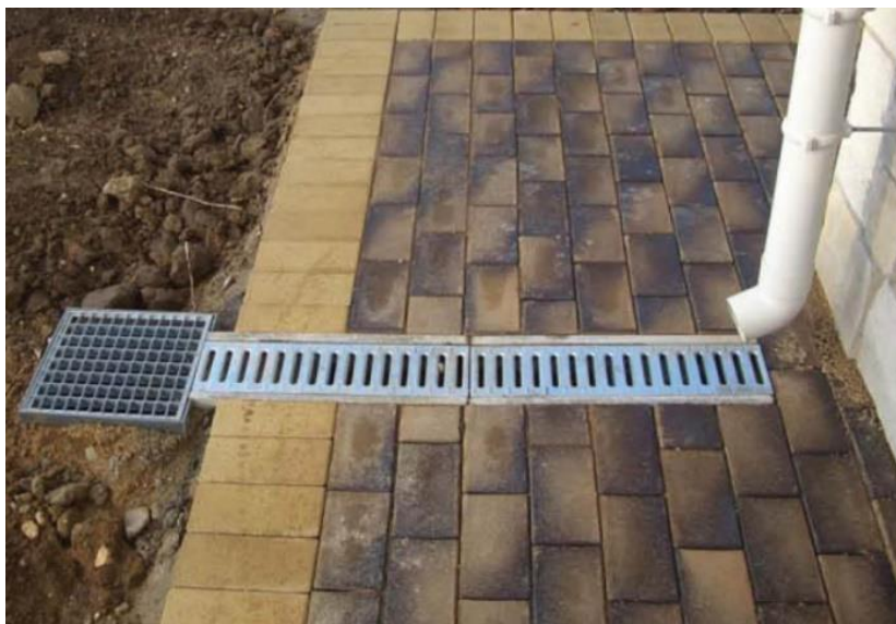
Slika 31. Cijevi za odvodnju
