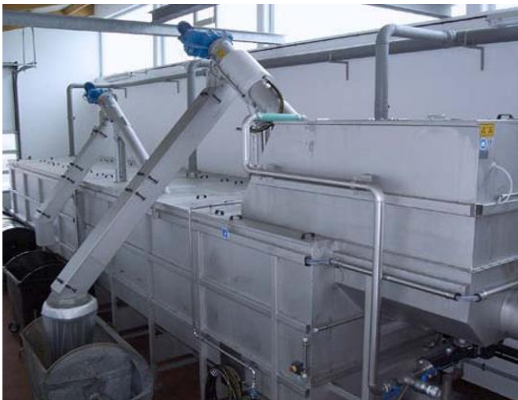
Slika 32: Integrirani uređaj za prethodno pročišćavanje (Izvor:[5])
