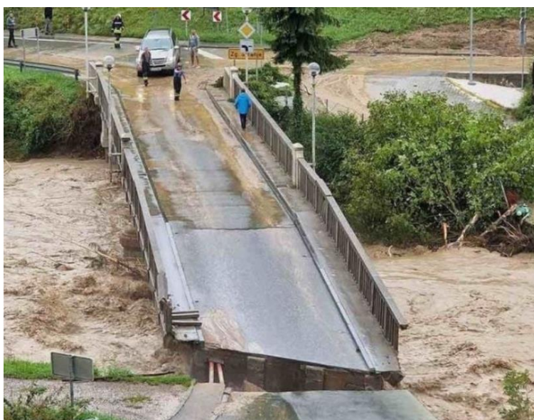
Slika 3 Most na državnoj cesti Strahovica-Kamnik, Slovenija nakon oštećenja
