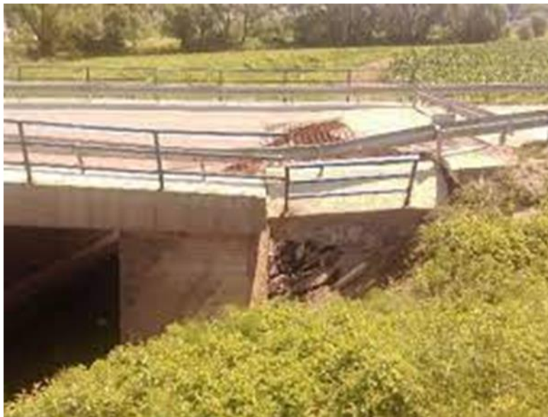
Slika 2 Most „Đurmanec“ nakon oštećenja
