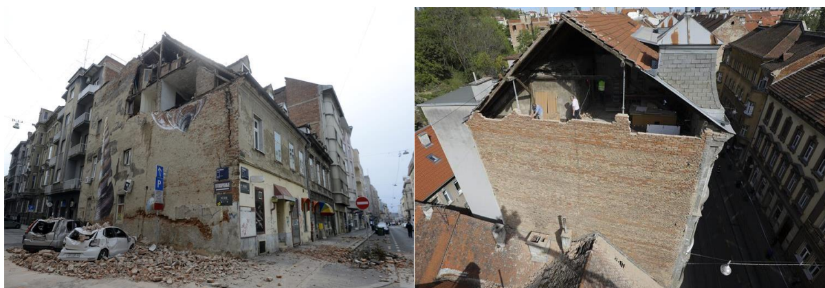
Slika 1 Oštećenja nakon potresa 2020. godine [3]
