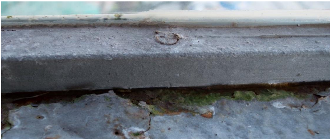
Slika 21.: Korozija u udubini (Izvor:[7])
