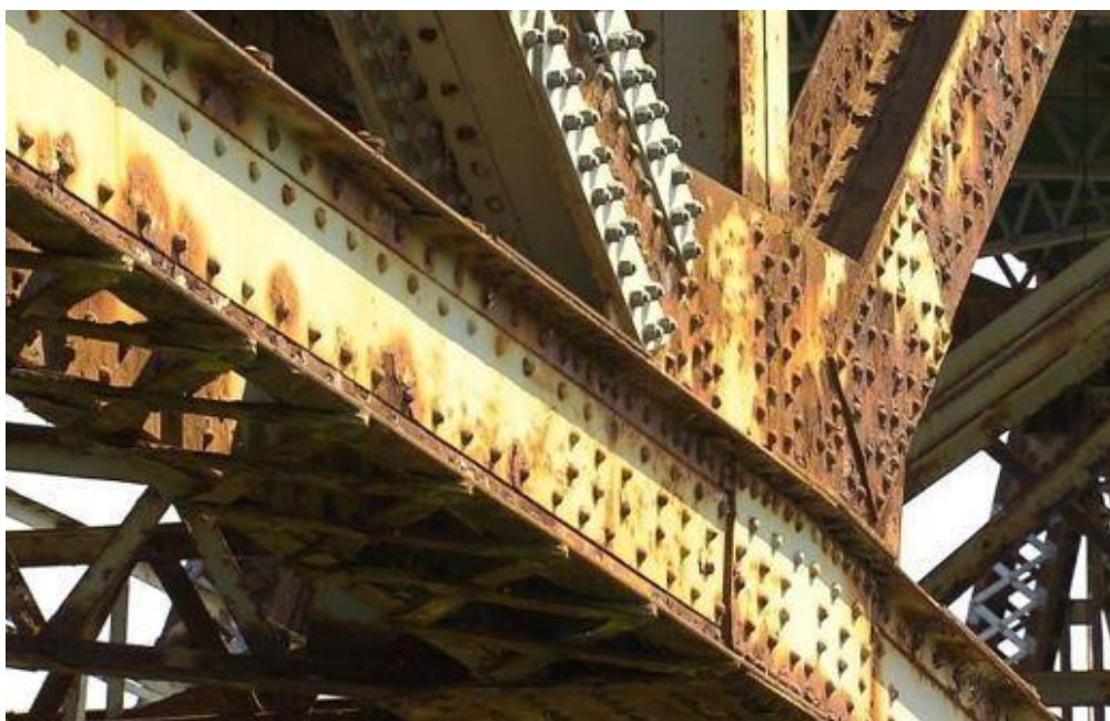
Slika 3.: Primjer hrđanja čelične konstrukcije (Izvor: [21])
