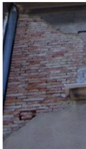
Slika 46. Prikaz oštećenja (Google Earth) (17)
