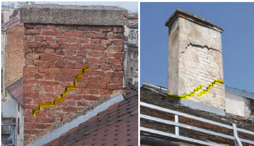
Slika 11. Prikaz tipičnih oštećenja na nepridržanim dimnjacima (15)
