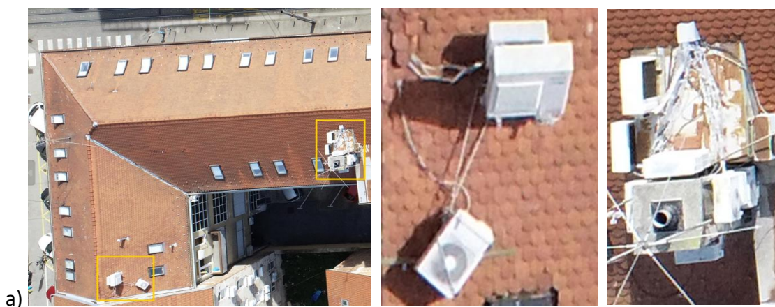
Slika 43. (a) Opći pogled na promatrani objekt ; (b) Instalacije neadekvatno pričvršćene na krovnu konstrukciju na visini iznad prolaza i balkona; (c) Visoki dimnjak (konzola) s neprikladnom količinom instalacija
