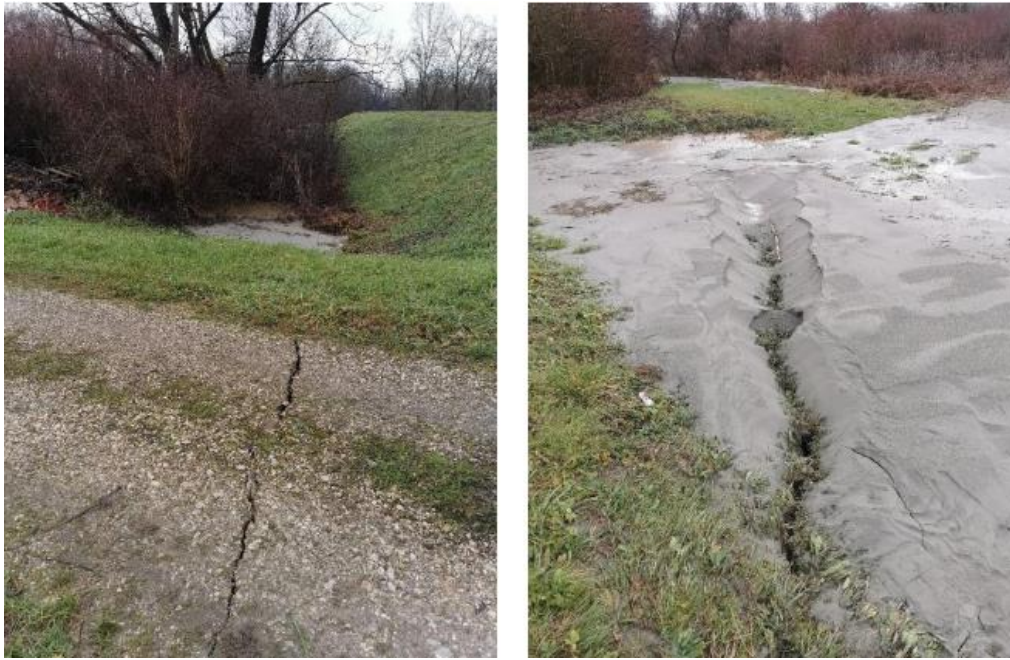
Slika 20.:Likvefakcijske pukotine (Izvor: [12])
