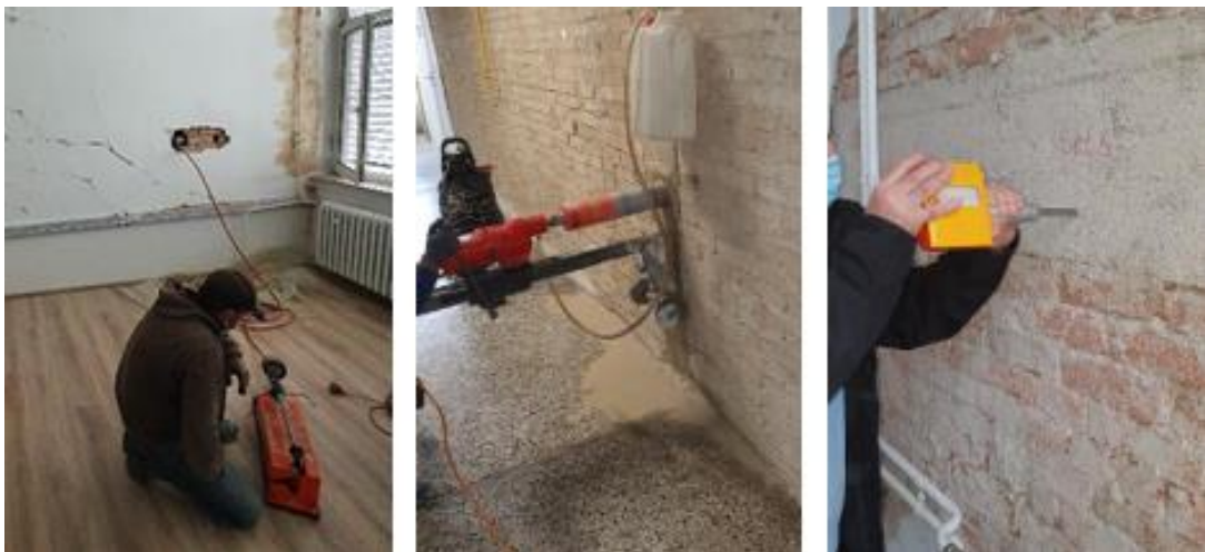
Slika 12.: Provedena ispitivanja ziđa [6]
