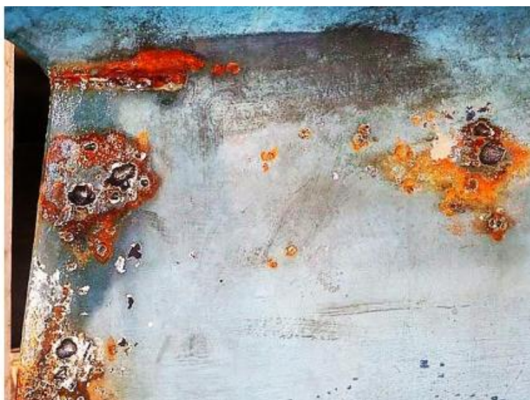
Slika 8.: Primjer pjegaste korozije [11]
