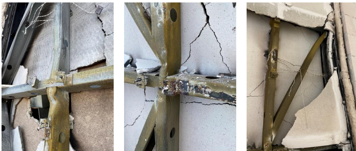
Slika 24: a) Čvor 6 nakon ispitivanja b) Čvor 10 nakon ispitivanja c) Čelična dijagonala između čvorova 8 i 11 nakon ispitivanja Panela 1
