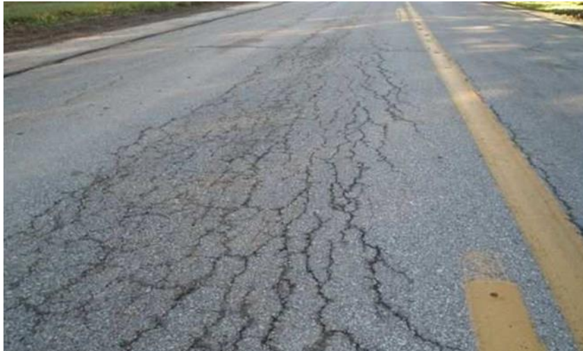
Slika 9: Pukotine na asfaltnom kolniku kao posljedica zamora [1]
