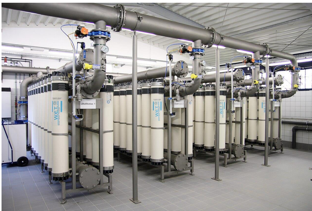
Slika 32: Postrojenje za proces ultrafiltracije [81]
