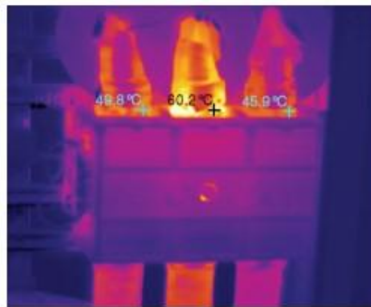
Slika 11. Temperaturna raspodjela elemenata električnih instalacija - kvantitativna termografija [1]
