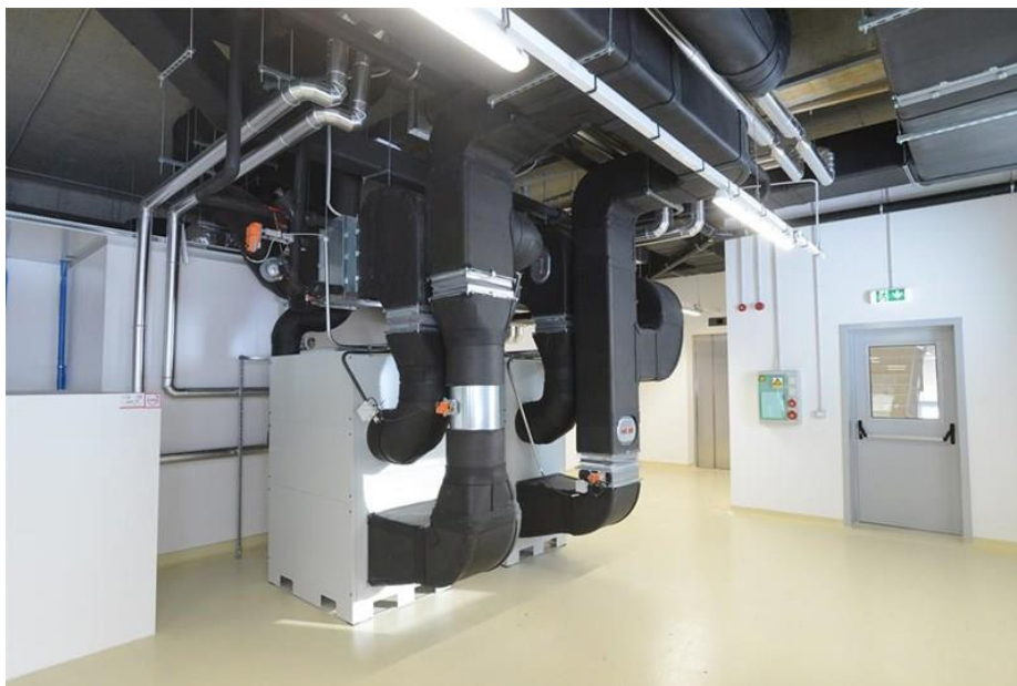
Slika 13. HVAC instalacije u Belupovom pogonu (Klimaoprema, 2022)
