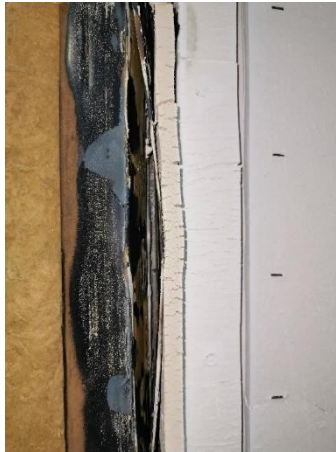
Slika 31. Pukotine na trakama
