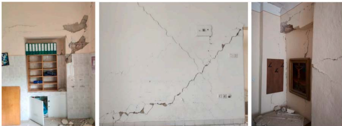
Slika 3.4 Smanjenje poprečnog presjeka zida (Stepinac i ostali, 2021).
