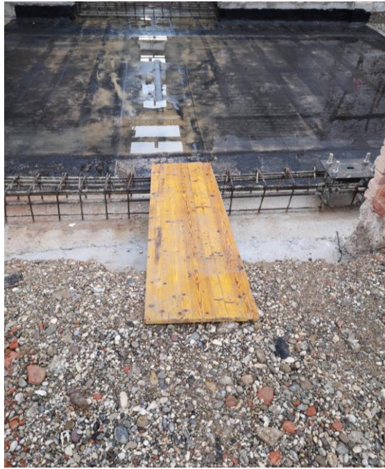
Slika 39 Nepravilno izvedena rampa za prijelaz
