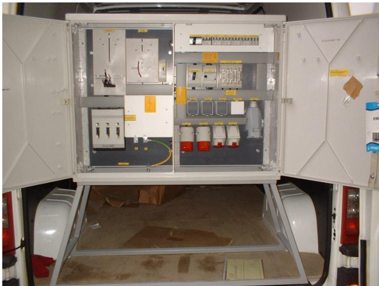
Slika 24 Priključni ormarić za struju (El-comm, 2023)
