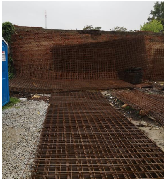
Slika 40 Neuredno skladište armature
