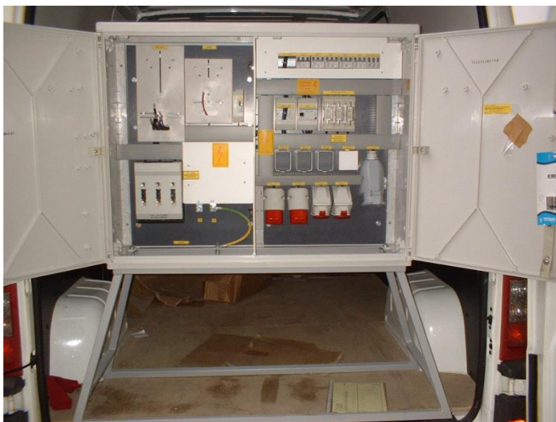
Slika 24 Priključni ormarić za struju (El-comm, 2023)
