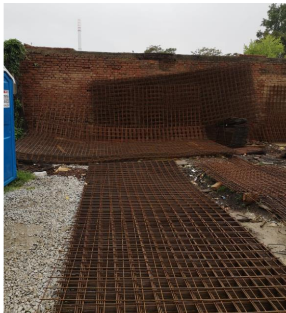
Slika 40 Neuredno skladište armature
