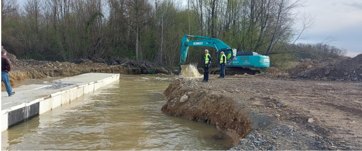
Slika 30. Poplavljeni propust (vlastita fotografija, 2023)
