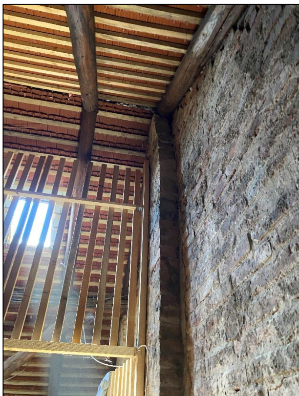
Slika 23 Popuštanje zida lastavice
