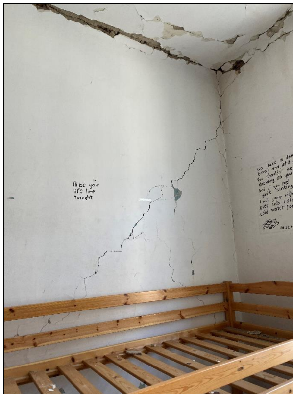
Slika 19 Dijagonalno oštećenje zidnog zida i drobljenje stropa trećeg kata lijevoga stana
