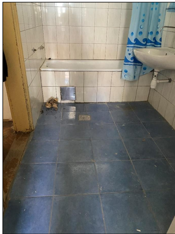
Slika 22 Udubljenje poda kupaonice trećeg kata lijevog stana
