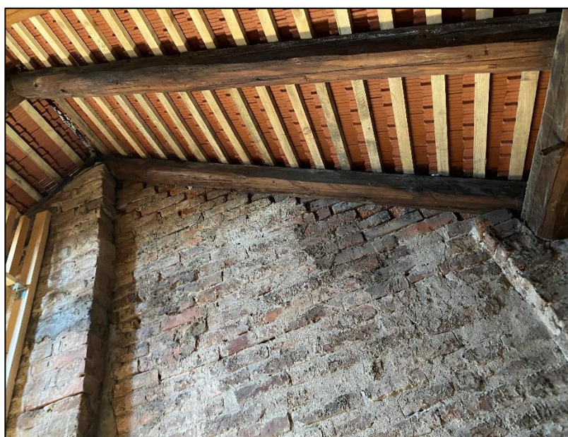
Slika 24 Oštećenje zabatnog zida
