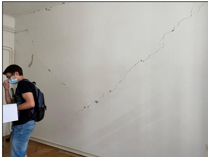
Slika 13 Dijagonalno oštećenje zida drugoga kata
