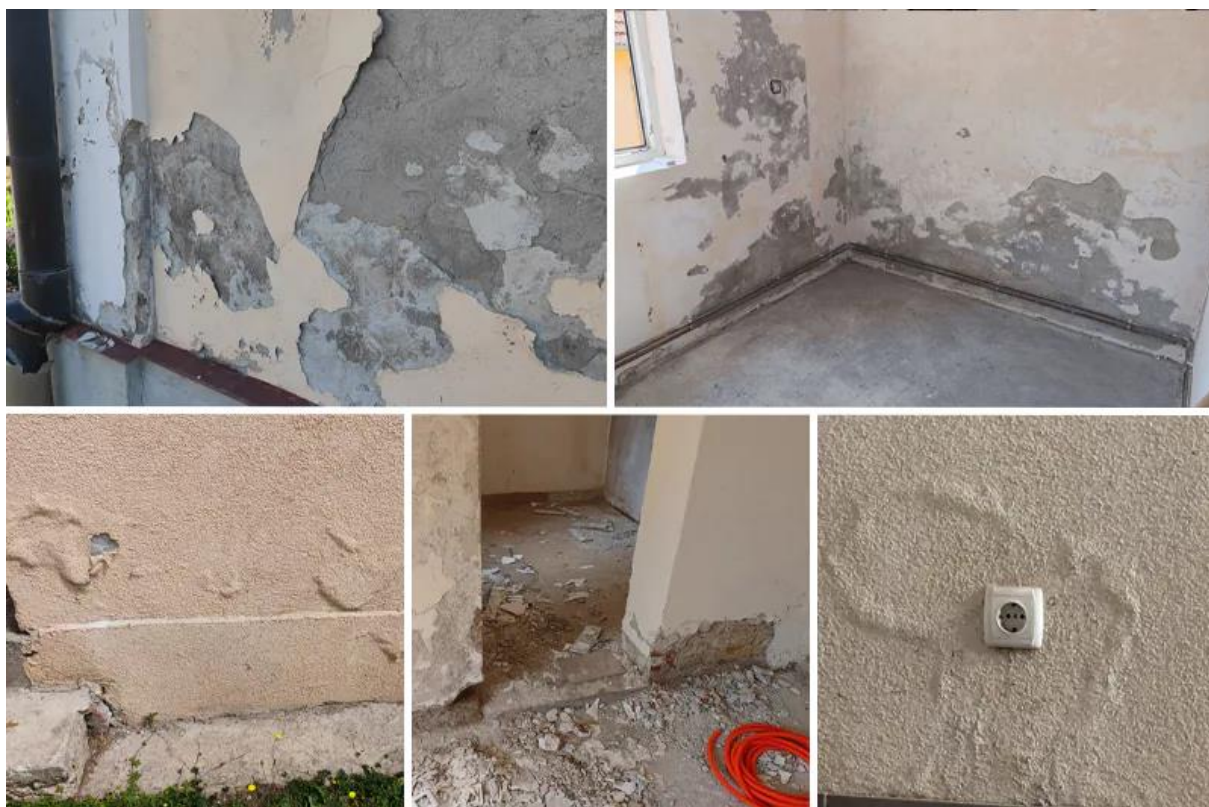
Slika 16. Štete na ovojnici kao posljedica loše kontrole prijenosa topline i vlage
